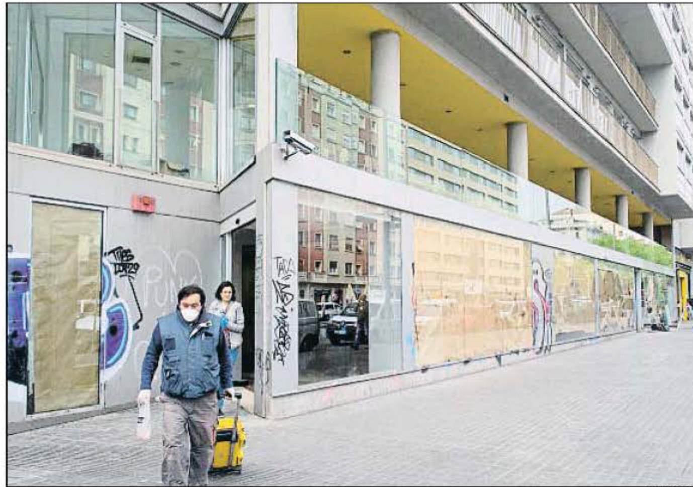
Hace una semana los operarios empezaron a adecuar el inmueble del número 63 del Paral·lel
