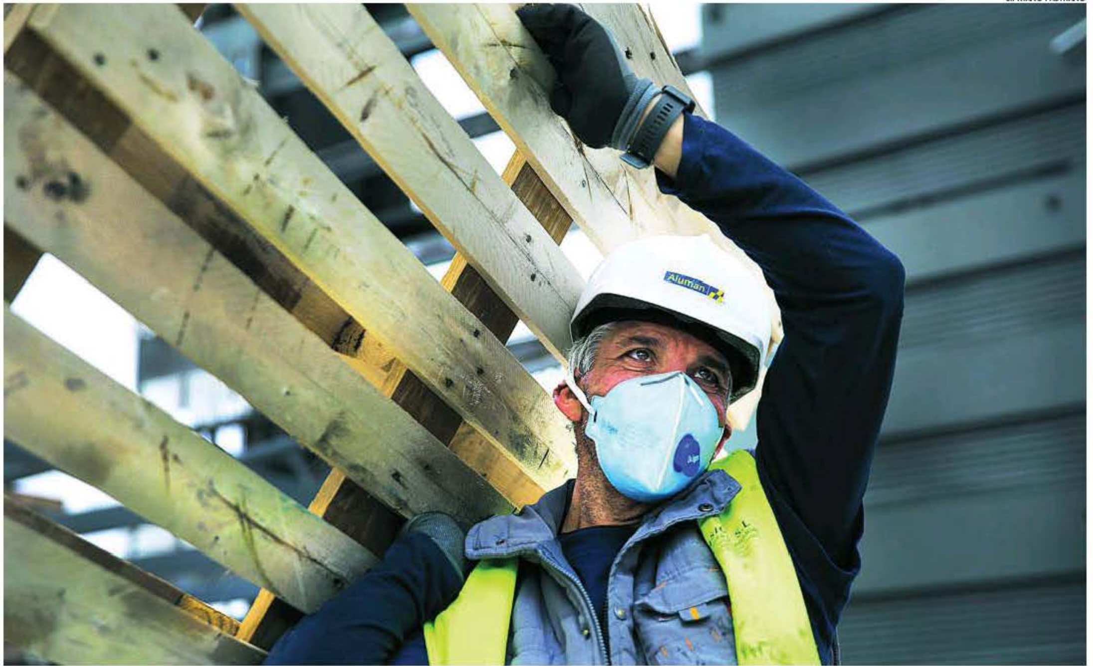
Un trabajador, ayer por la mañana, durante unas obras de rehabilitación de oficinas en el distrito madrileño de Ciudad Lineal
